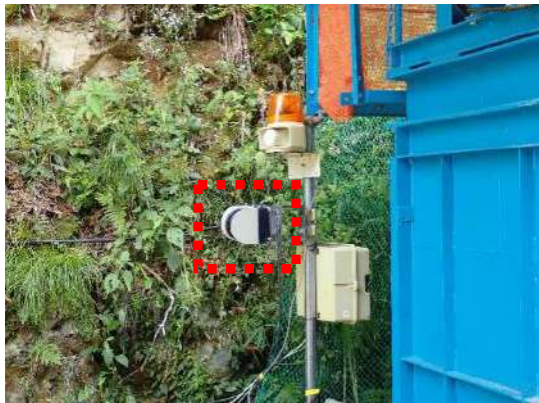
写真-4 非常停止装置
